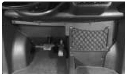
Fig. 18 - Emplacement de la boîte à fusibles.
